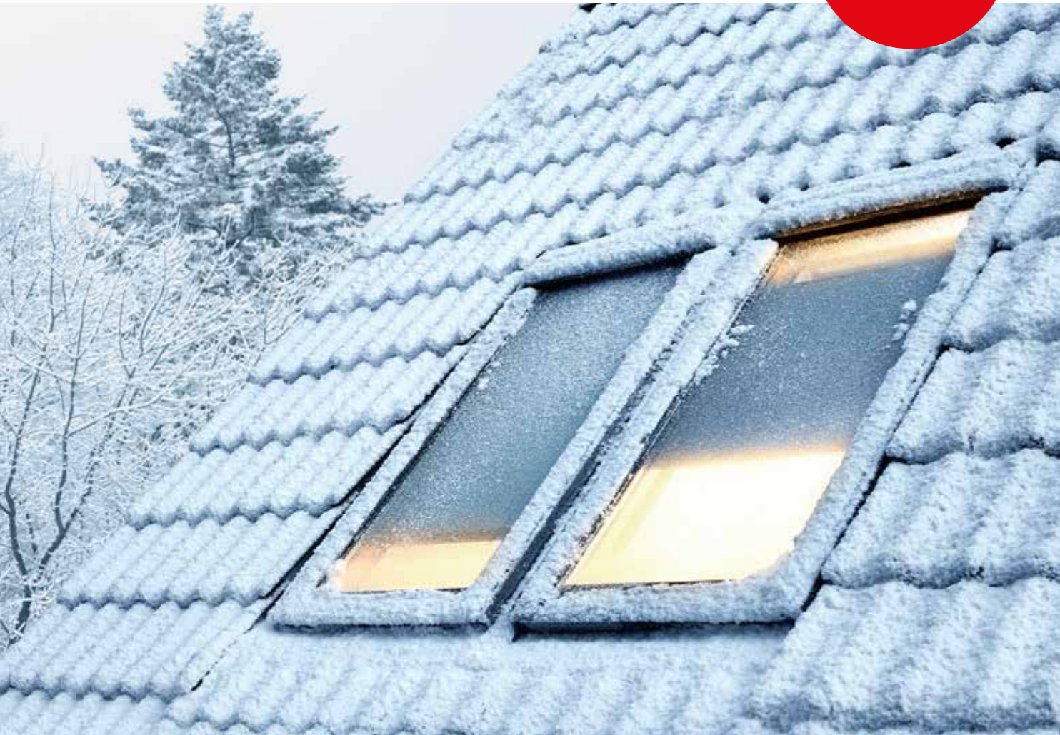
Velux har takvinduer godt tilpasset norsk klima.
