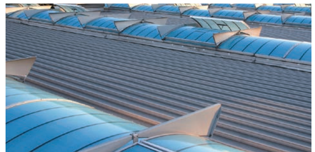
Gewölbtes Lichtband mit RWA-Doppelklappen und Windleitwänden
